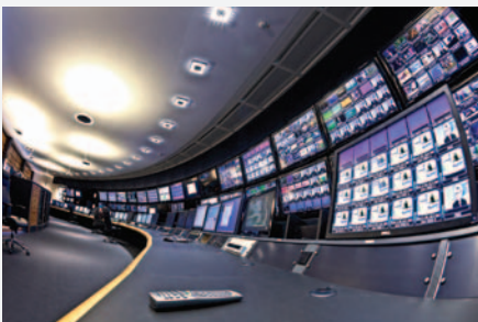
La salle de contrôle de SES Platform Services.
